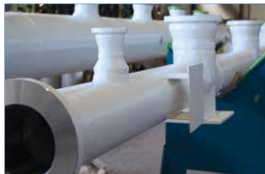
Collecteurs de mise en route et de production
